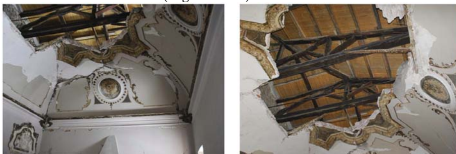
Figura 4.37. Immagini della volta parzialmente crollata
